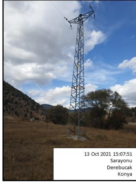
řekil IV.4 Saha Ziyareti Sırasında Çekilen Elektrik Diređi Fotođrafı
