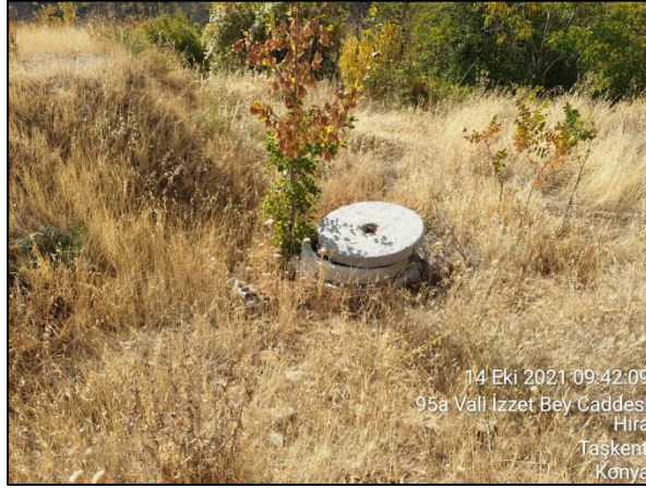
Artılmıř atık suyun deřarj edileceđi kanalizasyon bacası
